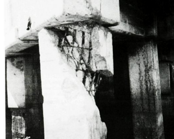
Hình 2. Cọc bến bị nứt vỡ do các va chạm của tàu.
