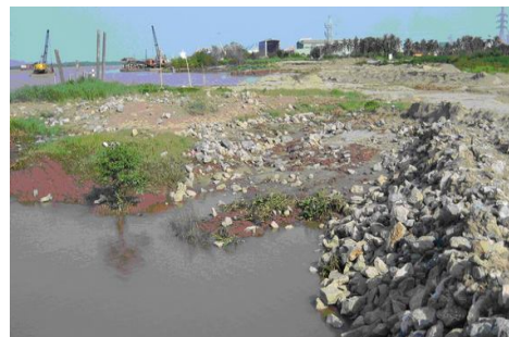
Hình 4. Xây dựng công trình phá huỷ thảm thực vật ven bờ.
