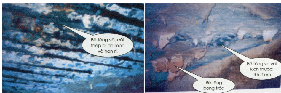
Hình 1. Sự biến chất của bê tông bản mặt cầu .
