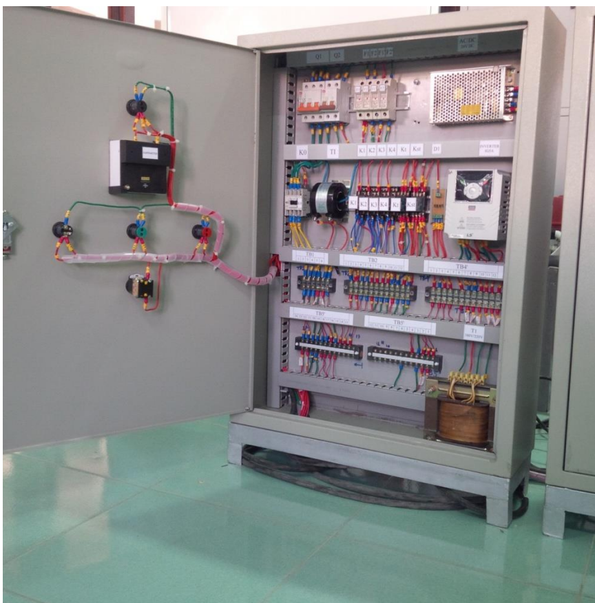
Hình 3.21 Bố trí thiết bị bên trong tủ khởi động bơm đã xây dựng
