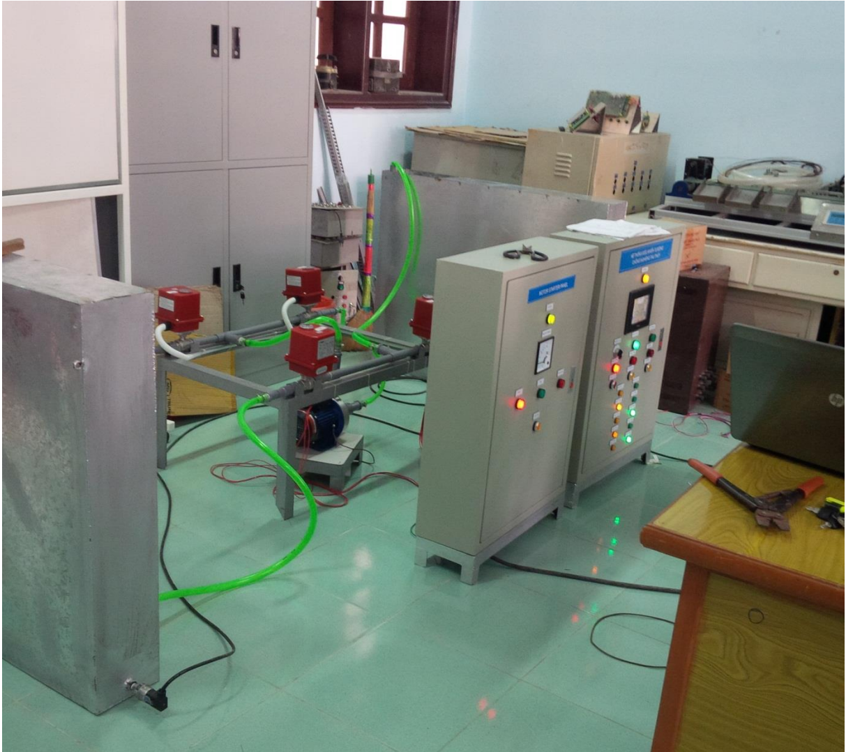
Hình 3.23 Thử nghiệm hệ thống làm việc ở chế độ tự động
