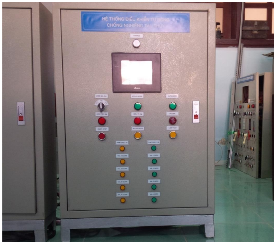
Hình 3.18 Mặt ngoài tủ điều khiển trung tâm đã xây dựng
