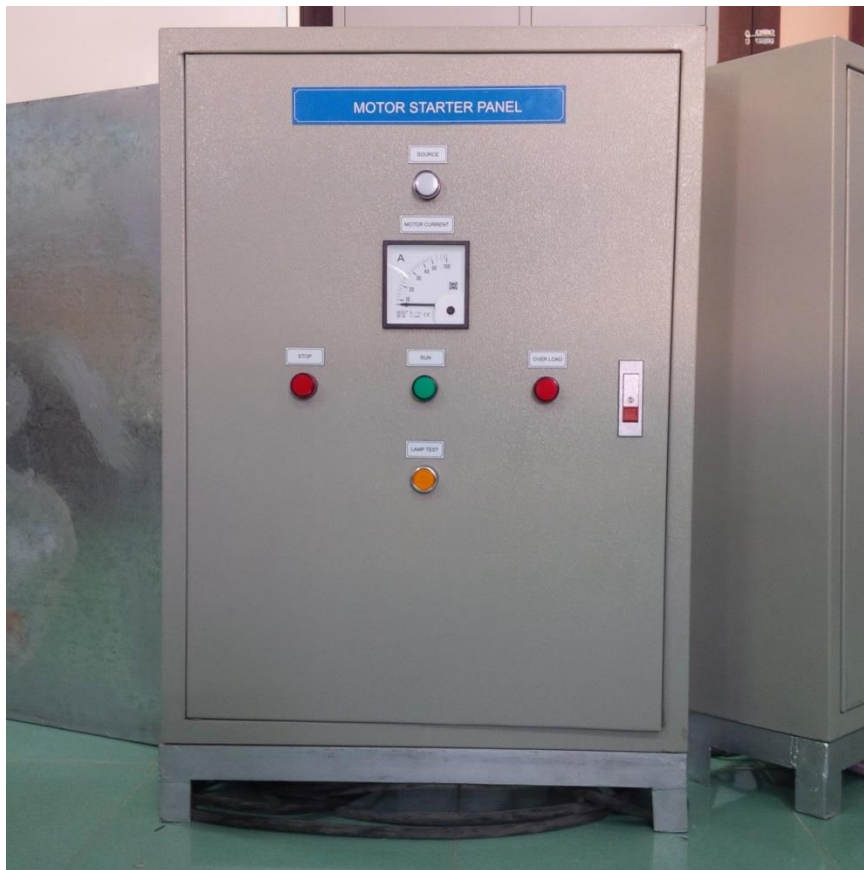
Hình 3.20 Mặt ngoài tủ khởi động bơm đã xây dựng
