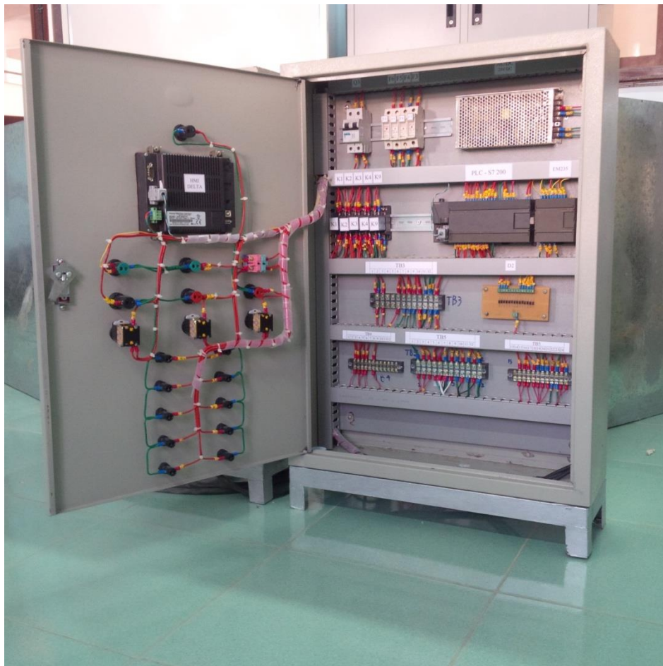
Hình 3.19 Bố trí thiết bị bên trong tủ điều khiển trung tâm đã xây dựng
