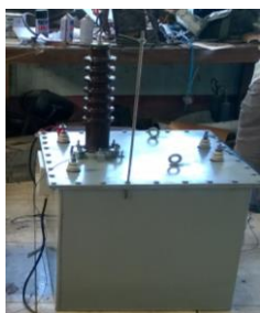
Hình 5. Máy biến áp
