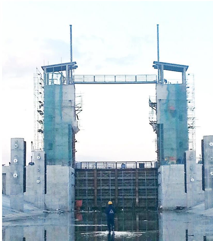
Hình 3 : Dự án Âu thuyền Rạch Chanh – Long An có buồng âu dài 140m, rộng đáy 19.5m, mái dốc 1:3, cao trình đáy âu -4.8, cao trình tường âu +2.7, đầu âu rộng 14.6m tháp nâng cao >15m; hai đầu âu được đóng mở bằng hệ thống cửa thép nâng thẳng đứng với sức nâng gần 100 tấn, kích thước 16.67mx7.63m
