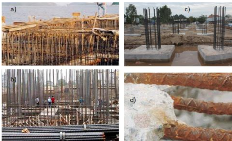
Hình 1. Hiện tượng gỉ của cốt thép chờ đổ bê tông. a) Dầm cầu cảng [1]; b) Cột nhà nhiều tầng; c) Móng nhà xưởng và d) Cận cảnh cốt thép bị gỉ tại mạch ngừng thi công [1].
