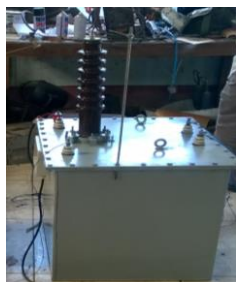
Hình 5. Máy biến áp
